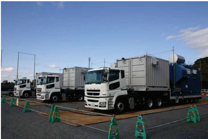
原電グラウンドに配備された高圧電源車 さらに2台追加される(日本原電より写真提供)
