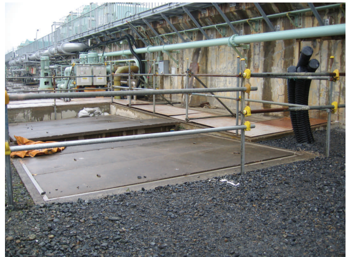
壁の奥が海水ポンプエリア（左側が海）
